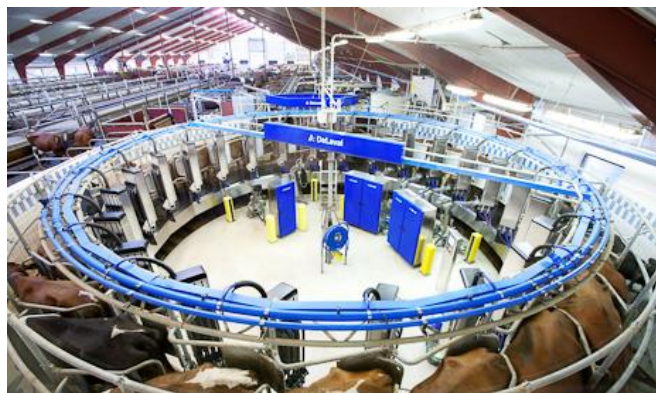
Карусельная доильная установка. Источник: IAK
